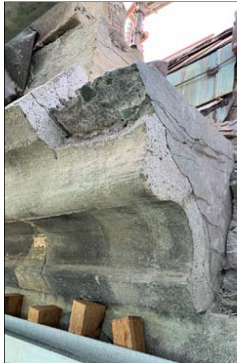
Der Gesims-Querschnitt zeigt Schäden an der Originalsubstanz des 19. Jahrhunderts durch Risse und Absprengungen und daran anschließend die verankerungsfreie Beton-Antragung der 1930er Jahre, die eine vereinfachte, dabei nicht funktionstüchtige Profilierung nachbildet.
